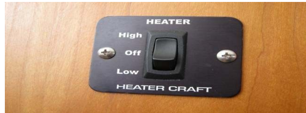
Heater Fan Control
